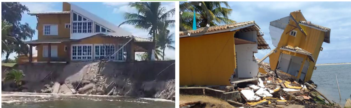
Figura 7 – Desabamento de sobrado em decorrência da erosão na porção estuarina da praia do Saco.
